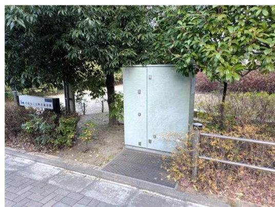
【開発公園に設置した地上機器】
