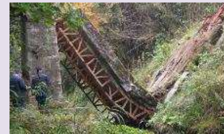
香川・徳島県境無名橋の落橋 (2007年)
