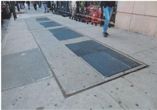
トランス類の歩道下への設置事例（ニューヨーク）
