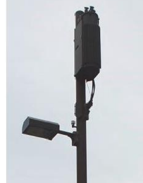
柱上トランス
