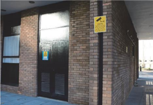
トランス類の建物内への設置事例（ロンドン）
