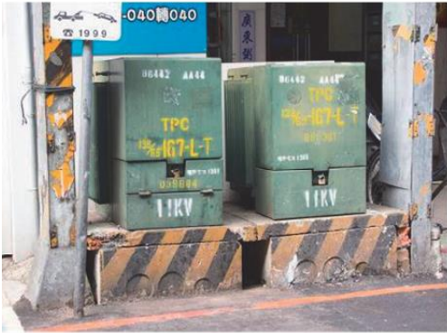
嵩上げして設置されたトランス類（台北）
