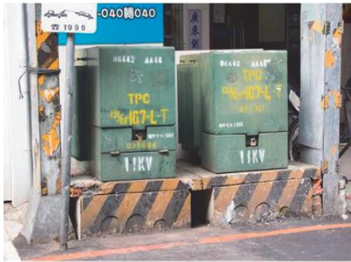
嵩上げて設置されたトランス類（台北）
