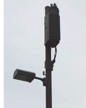
柱上トランス
