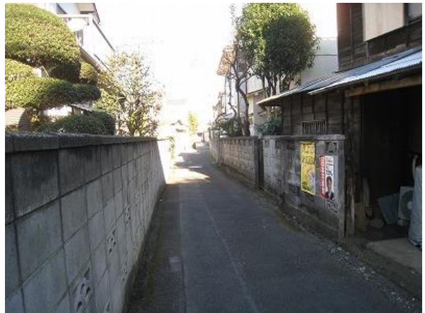
⑧狭隘道路沿いのブロック塀
