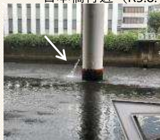
写真 雨天時の高架橋からの雨水路面排水 の流入 銚子橋付近 (R6.8.30)
