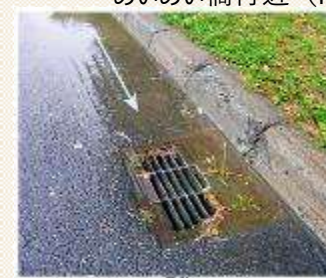
写真 側溝への雨水排水の流入 出典 国土交通省北海道開発局 帯広開発建設部 ( https://www.hkd.mlit.go.jp/ob/tisui/kds/pamp_hlet/kurashi/kurashi/03mizu_ha_dokohe.html )
