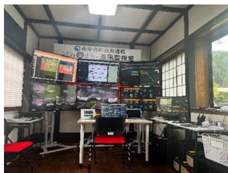
（遠隔監視室の様子）
