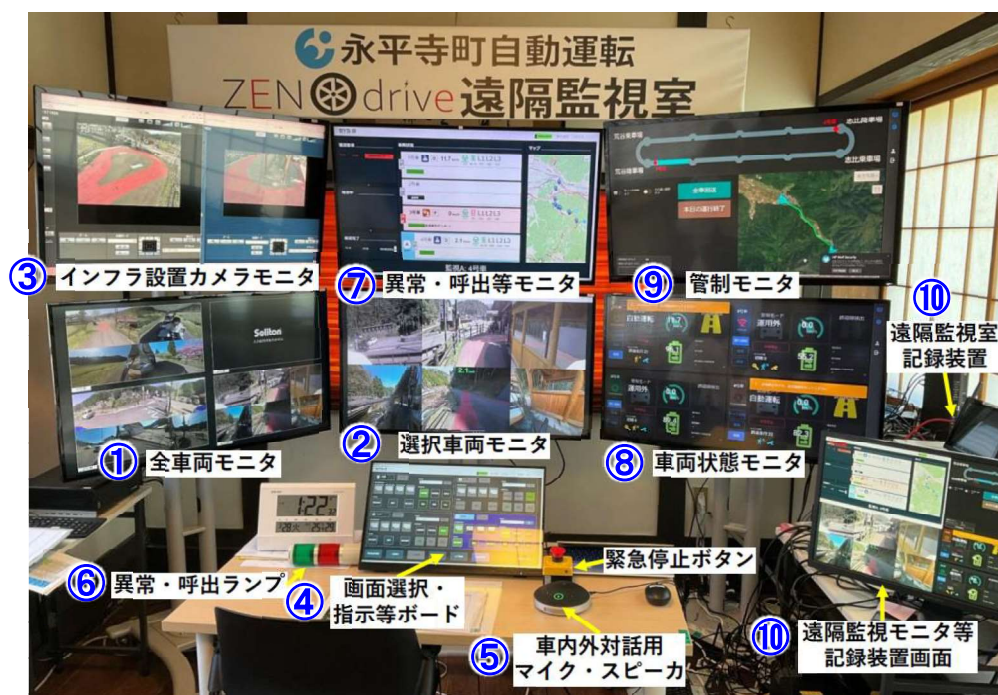
図 3-43 永平寺町の遠隔監視室
