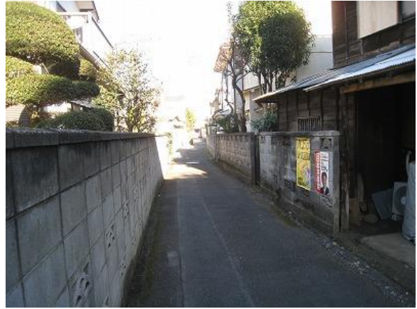
⑧狭隘道路沿いのブロック塀
