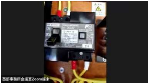
図 13 漏電遮断器の仕様確認
