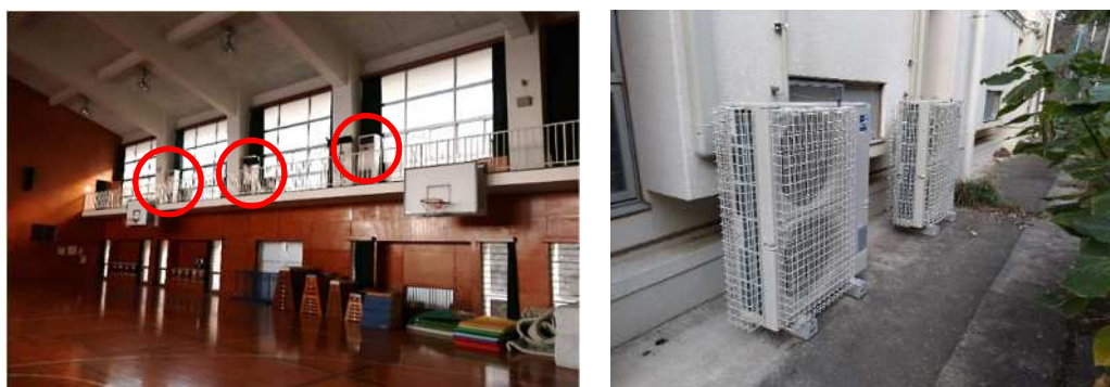
図9 設置された空調機
