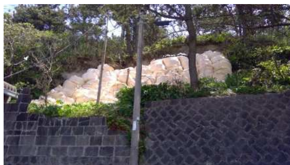
図10 斜面崩壊箇所の状況
