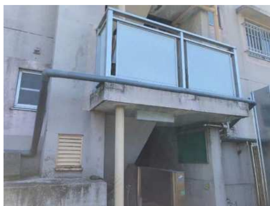
* 外壁に敷設された給水管
