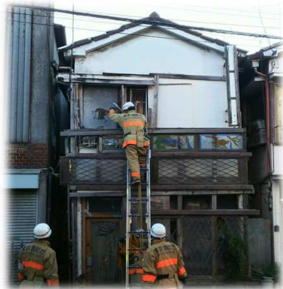
図8 消防隊による緊急避難措置の様子
