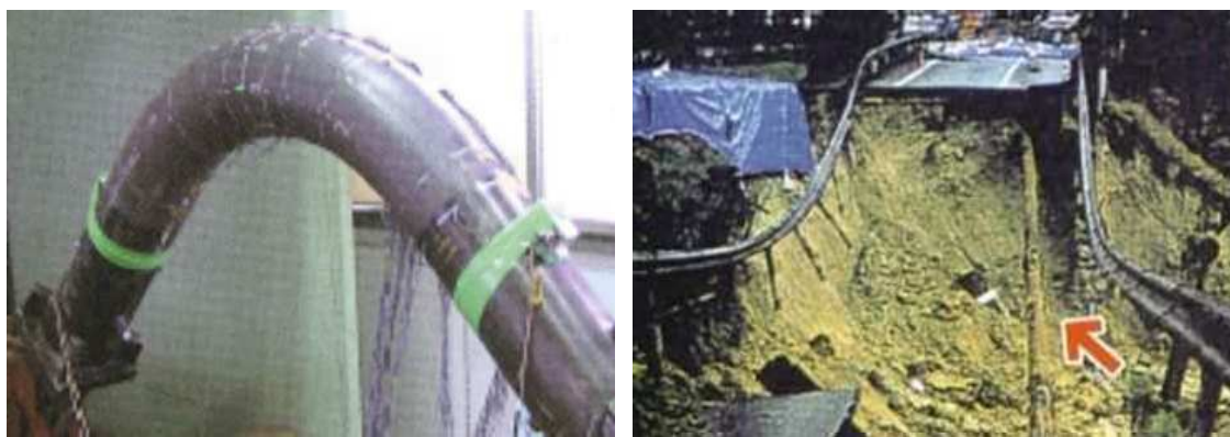
図 3 左) 可とう性のある中圧ガス導管、右) 道路崩壊時も健全な中圧ガス導管
