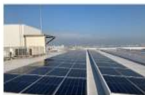
太陽光発電設備（PV：Photovoltaic Power Generation）
